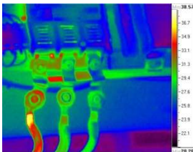
Рисунок 21. Пример термограммы контактных соединений с температурной шкалой
